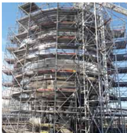
Izolace kulového zásobníku
