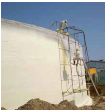
Tepelná izolace vnějšího pláště fermentoru
