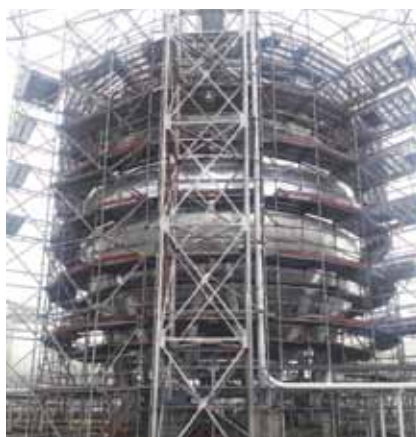
Izolace kulového zásobníku
