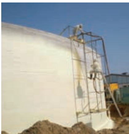
Tepelná izolace vnějšího pláště fermentoru
