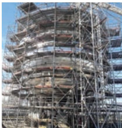
Izolace kulového zásobníku
