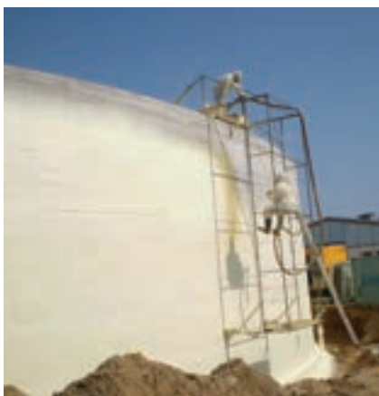
Tepelná izolace vnějšího pláště fermentoru
