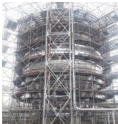
Izolace kulového zásobníku
